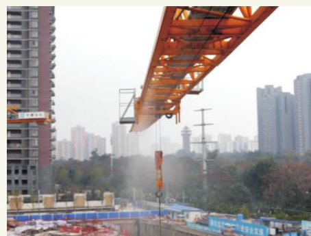
塔吊喷淋系统
