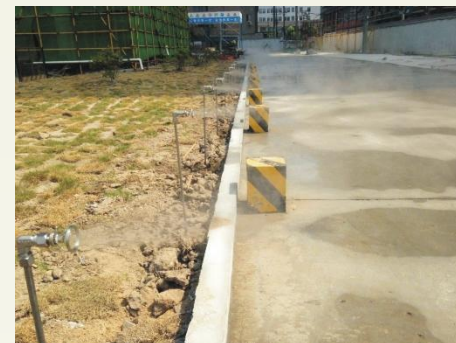
道路喷淋系统
