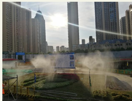
洒水冲洗喷淋系统
