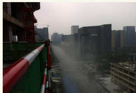
楼层层间喷淋系统
