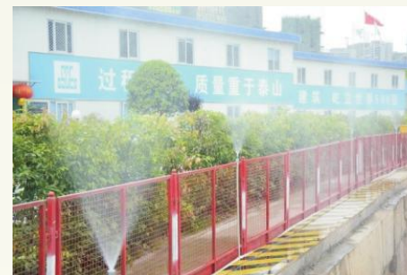
基坑喷淋系统
