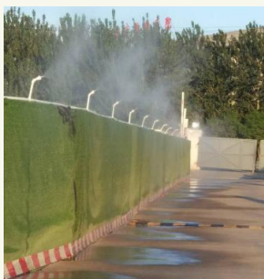
道路喷淋系统
